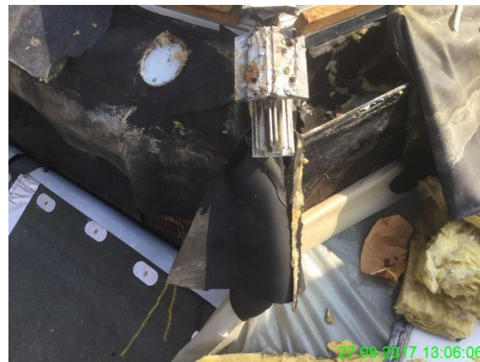
Fehlende Verbindung der Dampfsperre an die Lichtkuppel
