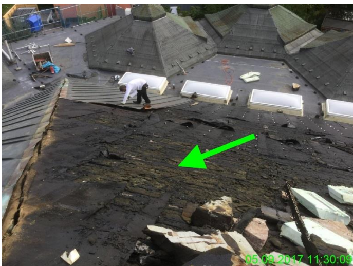
Erkennbare Frostschäden an der Oberfläche des Dämmstoffes
