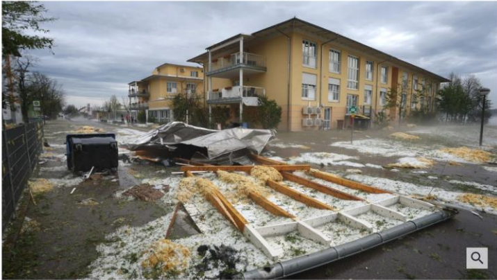
Ein vom Sturm abgetragenes Dach eines Seniorenheims liegt neben einer umgestürzten Mülltonne auf einem Parkplatz. Foto: Karl-Josef Hildenbrand/dpa (Foto: dpa)
